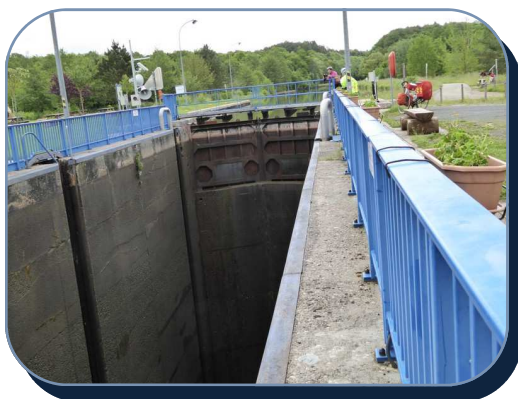
Une des nombreuses écluses rencontrées
